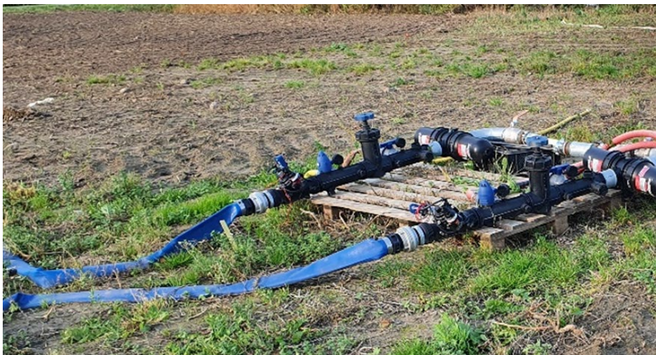
Figur 29. Matarledning med styr och kontrollenhet samt filter för två skilda droppbevattningsavdelningar. Källa: Per-Anders Algerbo
